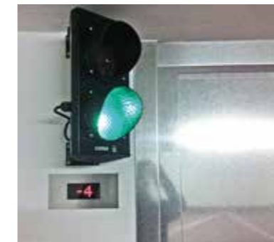
Détail des feux de circulation
